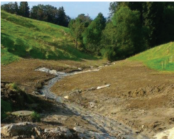
Steinschlagschutz Charmey; Realisierung 20??
