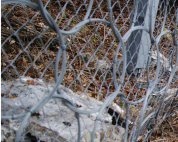
Steinschlagschutz Charmey; Realisierung 20??
